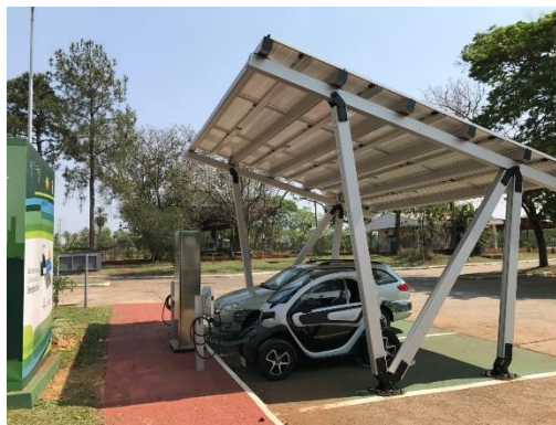
Figura 9. Resultado Final del Proyecto, sistema de carga de vehículos eléctricos con energía solar instalado y funcionando en el CRV de Itaipu.
