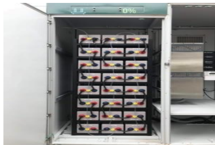
Figura 6. Banco de Baterías montado dentro del Gabinete
