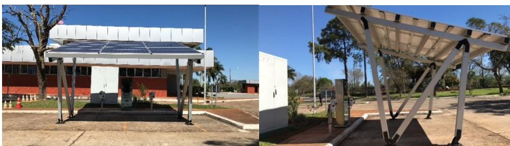
Figura 2. Estructura de soporte de los paneles solares montada en el CRV de Itaipu.
