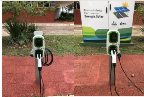
Figura 7. SAVE de la marca ROLEC instalados en el CRV de Itaipu.
